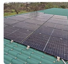
15kWp στον Κολωνό Μάρτιος 2026
